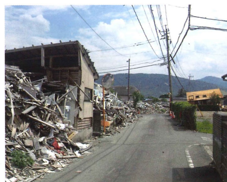
熊本地震で倒壊した住宅。「倒壊」=人の生存空間が残らないほど崩れ落ちた状態。「全壊」=倒壊はまぬがれても、構造の柱・梁が破壊された状態
